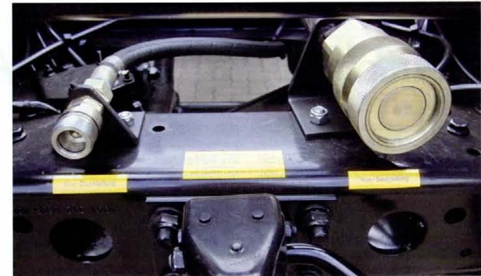
Standleitung: Anschlüsse der Unimog Bord-Hydraulik für den Kranbetrieb
